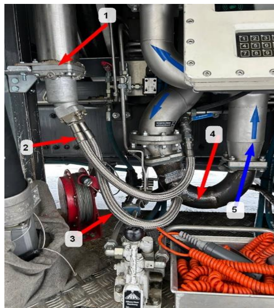
Рисунок 33 -Общий вид техотсека ТЗА-22-FM с дозатором на основе ГСШД: 1-топливопровод от насоса; 2 - клапан-«ИНЛАЙН»; 3 –топливопровод после фильтра-водоотделителя; 4 - фильтр-водоотделитель
